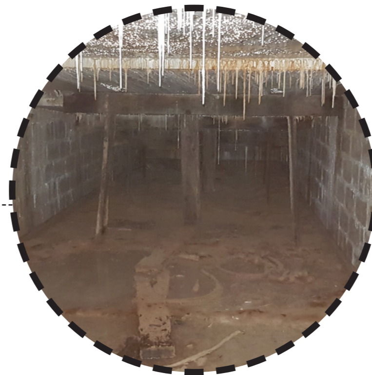
ÉTAT DE DÉGRADATION AVANCÉ
