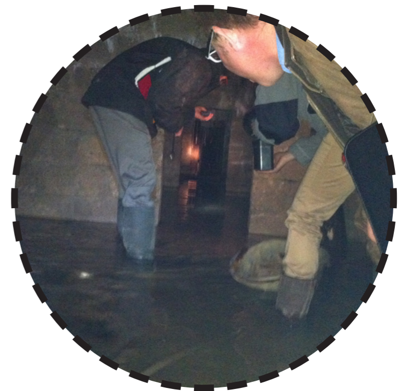
ÉTANCHÉITÉ À REFAIRE
